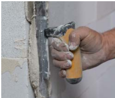
Hjørner rettes av med Ytong Se-mentsparkel eller Ytong Gipsuss, som trekkes ut over hjørnet med stålbrett eller sparkel.
